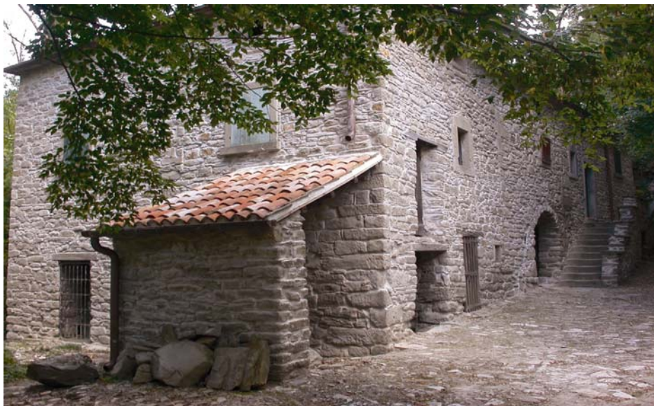
Il mulino della Madonna in corso di ristrutturazione posto immediatamente a monte della confluenza del rio Zafferino nel torrente Sillaro
